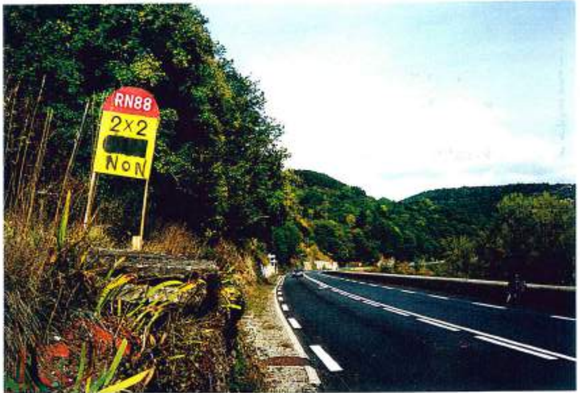
48-37 (n°33-6A) - La N88 après Badaroux au lieu-dit La Baraque: 400m dangereux, à sécuriser pour le passage de la Véloroute
