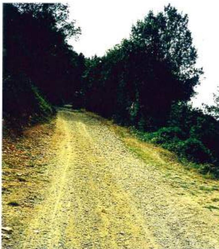
48-15 (n°27-2°-10A) - Chemin bord du Lot entre Les Salelles et Chanac : descente de Le Villard 600m à améliorer
