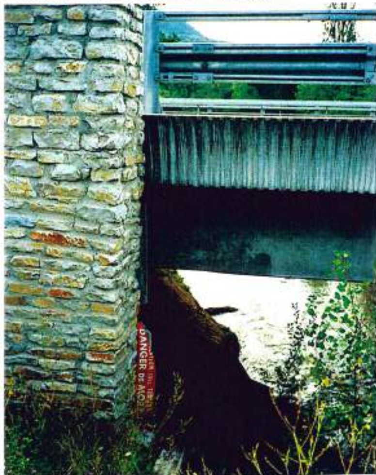
48-7 (n°26-2°-11A) - La Mothe-Banassac, le pont de l'autoroute A75: le passage sous le pont de l'autoroute, espace existant (2m de large)
