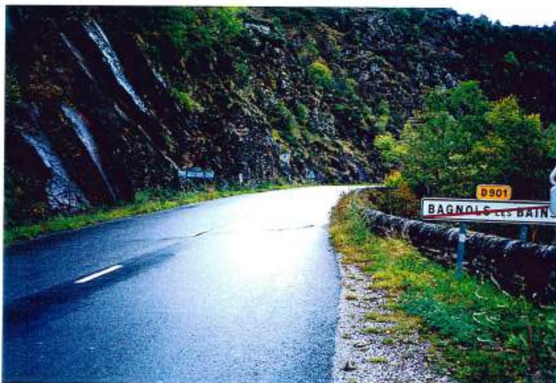
48-48 (n°33-24A) - D901 de Bagnols-les-Bains à Le Bleymard : à la sortie de Bagnols (chaussée de 6m), route à sécuriser par petites sur-largeurs
