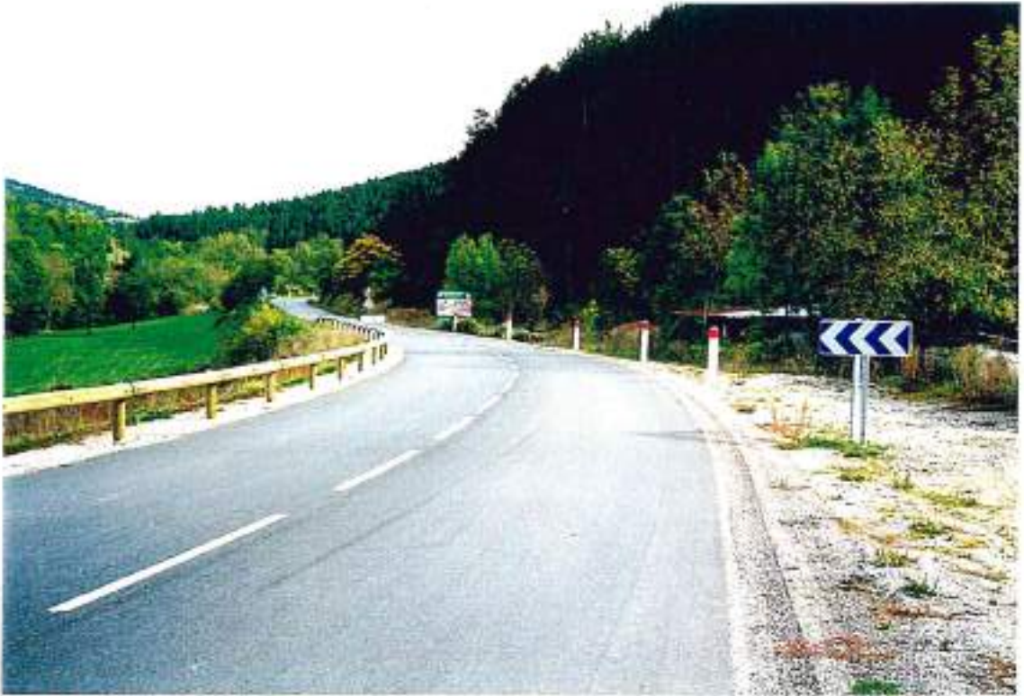
48-45 (n°33-12A) - La D901 à Nojaret : ici chaussée de 7m, route à sécuriser par petites sur-largeurs
